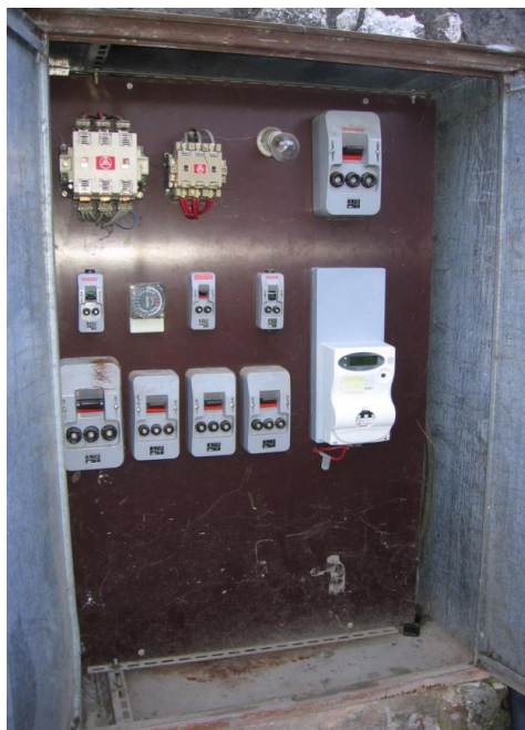
Fig. 30 – Il quadro installato in località Covelo a Civezzano
