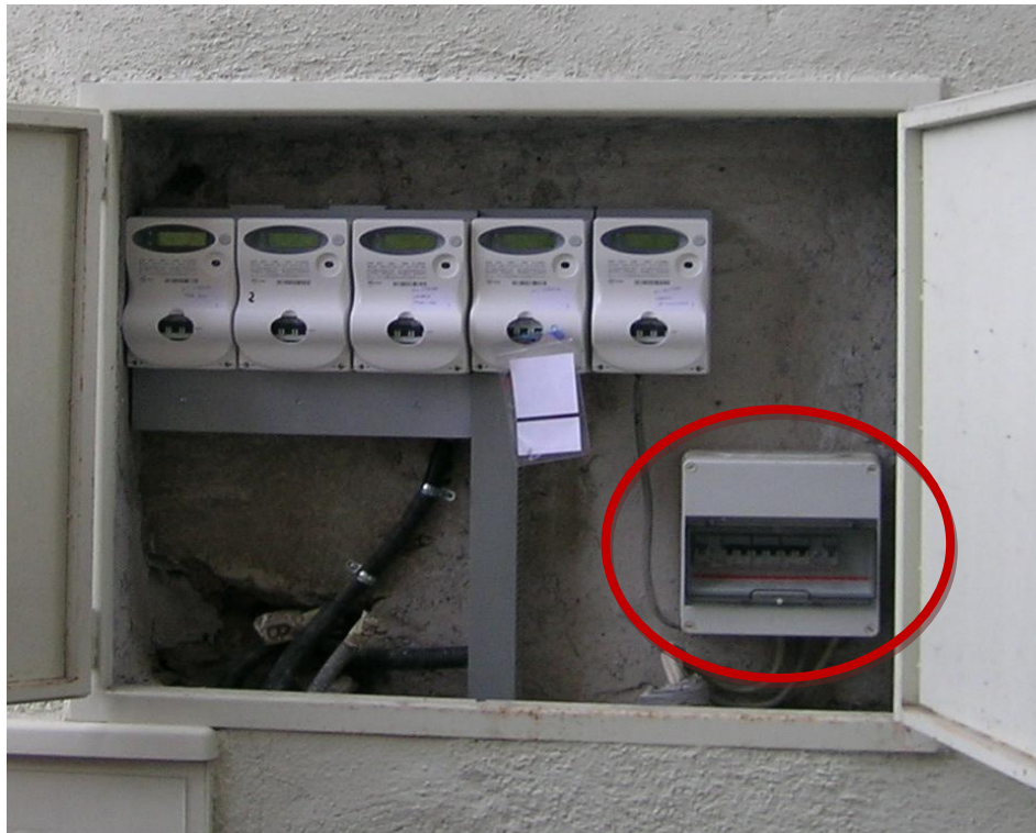
Fig. 22 – Il quadro dell'impianto di illuminazione pubblica di Barisei
