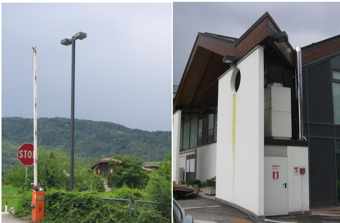
Fig. 67 – Corpi illuminanti installati all'esterno del centro commerciale: lampade su palo e a muro
