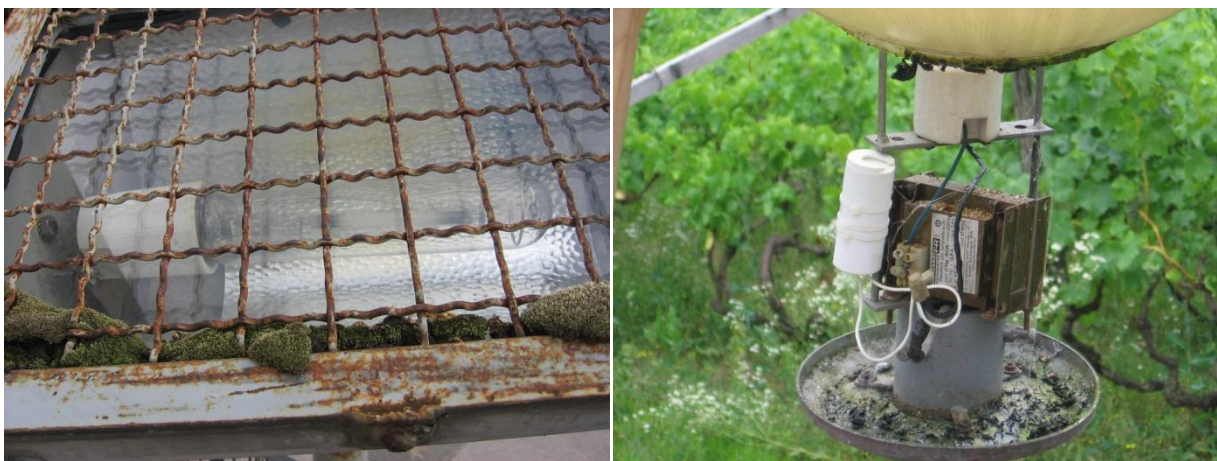
Fig. 39 – Situazioni critiche individuate per lo stato di protezione dei corpi illuminanti
