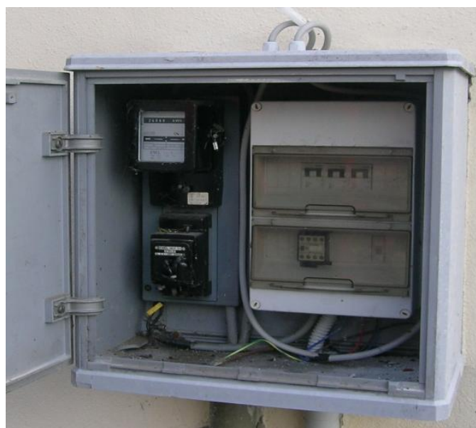
Fig. 26 – Il quadro installato in località Ochi
