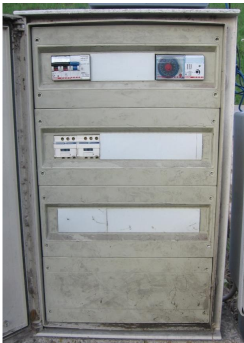
Fig. 28 – Il quadro installato in località alle Campagne
