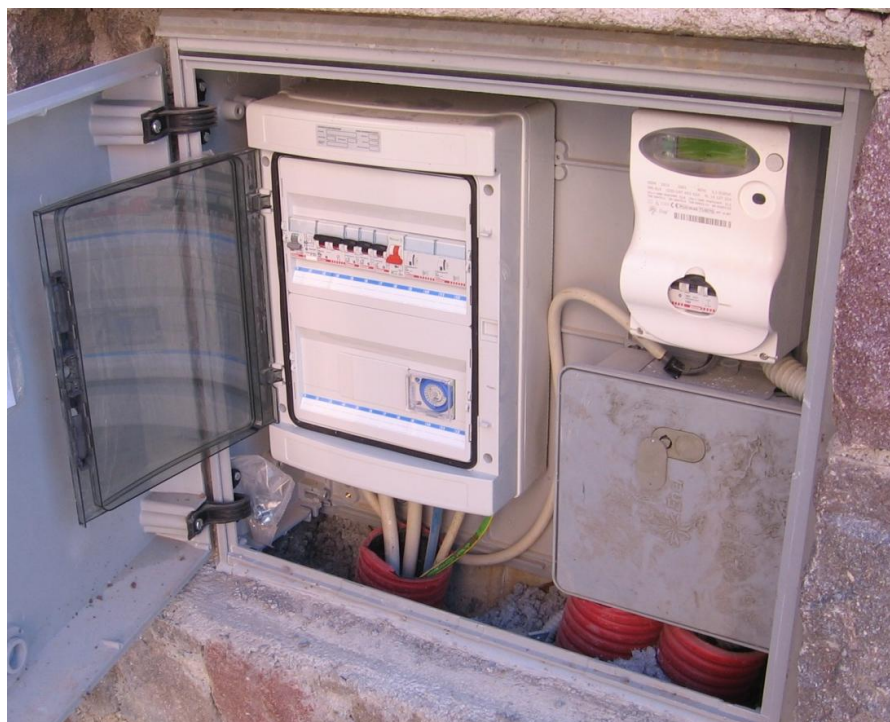
Fig. 36 – Il quadro a servizio della frazione di Garzano
