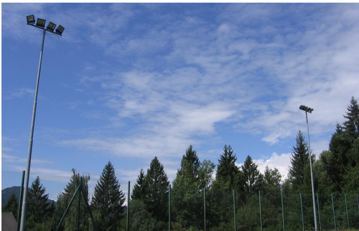
Fig. 59 – Punti luce con 4 fari agli ioduri metallici di potenza pari a 400 W, installati al campo sportivo di S.Agnese.
