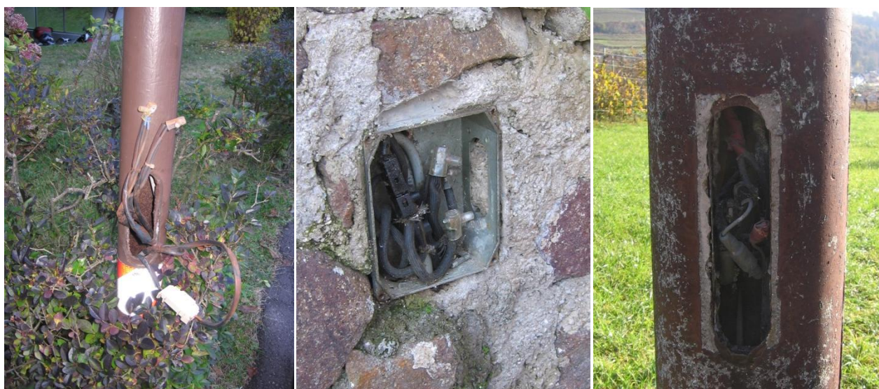
Fig. 38 – Situazioni critiche individuate per lo stato di conservazione dei collegamenti elettrici
