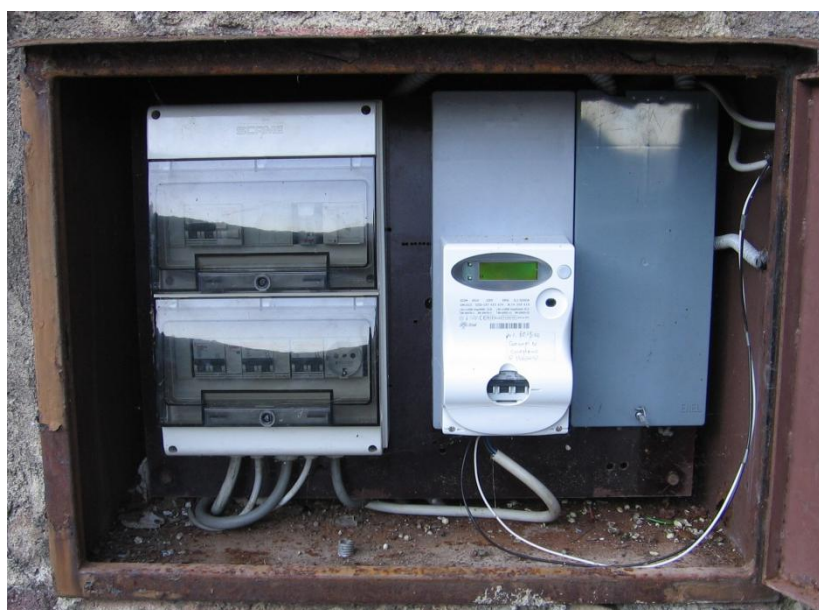
Fig. 37 – Il quadro a servizio della frazione di Magnago. In colore bianco e nero si posso notare i cavi sopra citati
