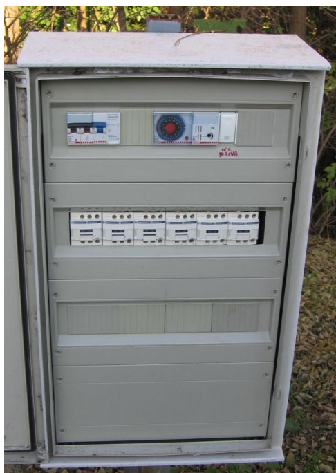
Fig. 29 – Il quadro installato in Via Roma a Civezzano
