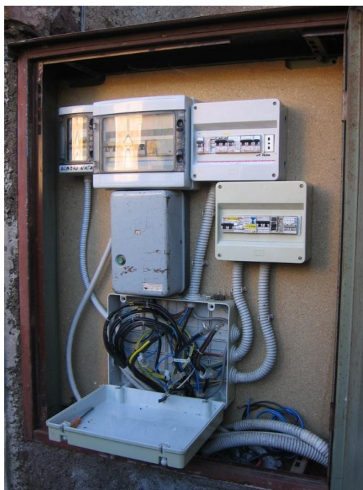
Fig. 32 – Il quadro Q29 – Civezzano centro
