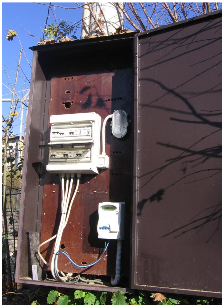
Fig. 12 – Il quadro installato in frazione S. Agnese
