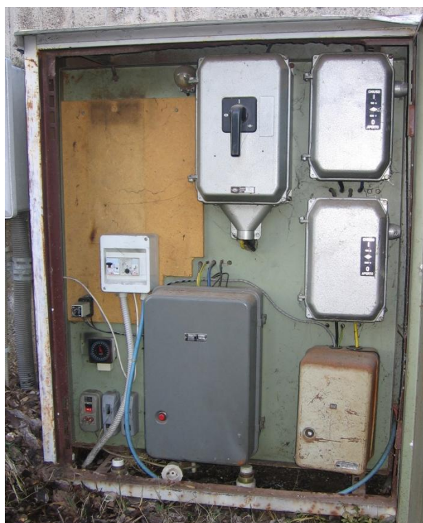
Fig. 31 – Il quadro installato in Via Fersina Avisio a Civezzano
