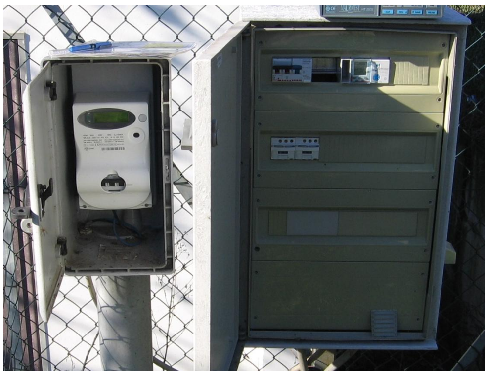
Fig. 23 – Il quadro dell'impianto di illuminazione pubblica installato presso il centro commerciale
