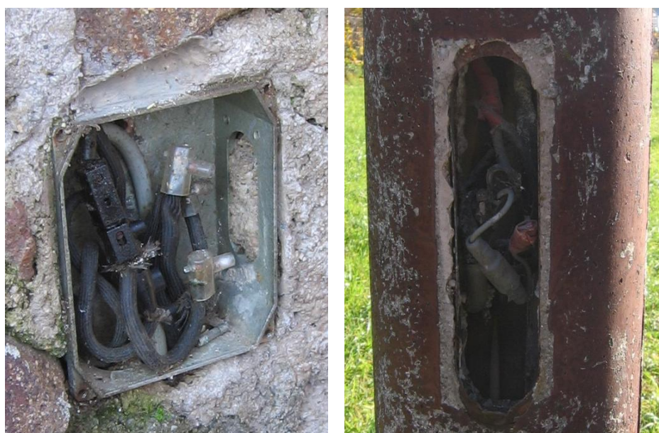
Fig. 35 – Particolare di derivazioni per l'alimentazione di punti luce
