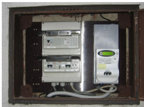
Fig. 19 – Il quadro a servizio dell'impianto di illuminazione di Roverè
