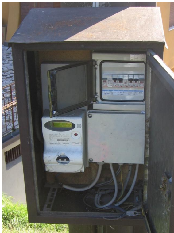
Fig. 24 – Il quadro installato in località Mochena
