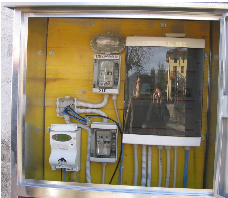
Fig. 13 – Il quadro installato sulla cabina di trasformazione a Mazzanigo
