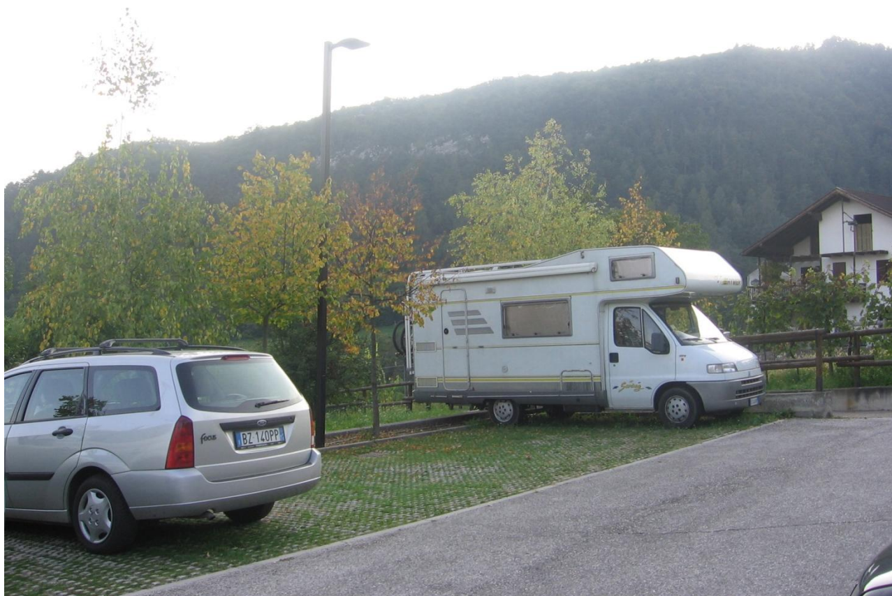
Fig. 65 – Fari a LED della potenza di 60 W per l'illuminazione del parcheggio nella frazione di Orzano.
