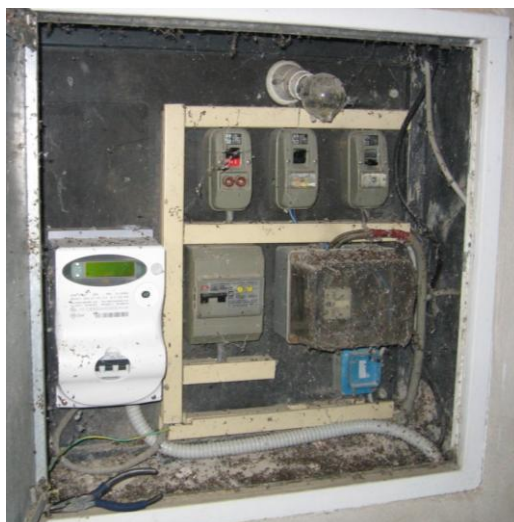
Fig. 20 – Il quadro dell'impianto di illuminazione pubblica di Parnevale
