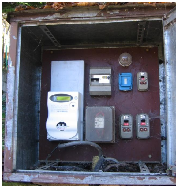
Fig. 25 – Il quadro installato in località Slacche
