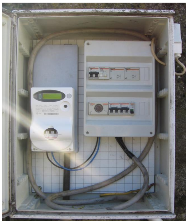
Fig. 21 – Il quadro dell'impianto di illuminazione pubblica in loc. Campagnale
