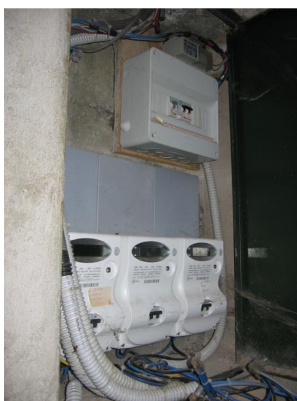
Fig. 11 – Il quadro installato in frazione Fratte
