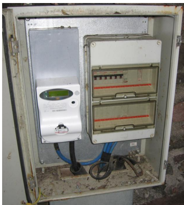
Fig. 18 – Il quadro a servizio della frazione Gentilotti
