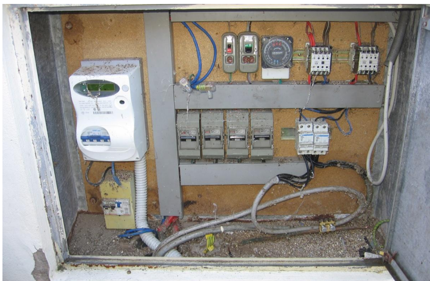
Fig. 33 – Il quadro Q31 – Civezzano nord
