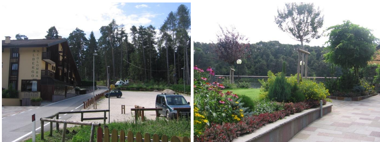
Fig. 68 – Corpi illuminanti del tipo testapalo e a globo (classe E) installati presso l'Hotel S. Colomba
